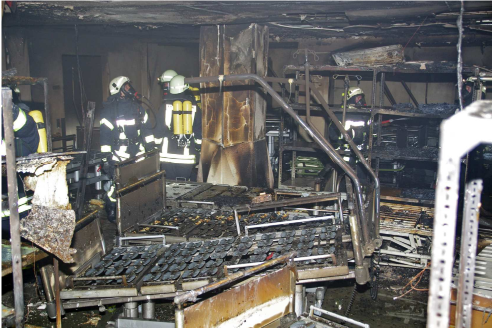
Das vom Feuer zerstörte Bettenlager im Keller des Klinikums
